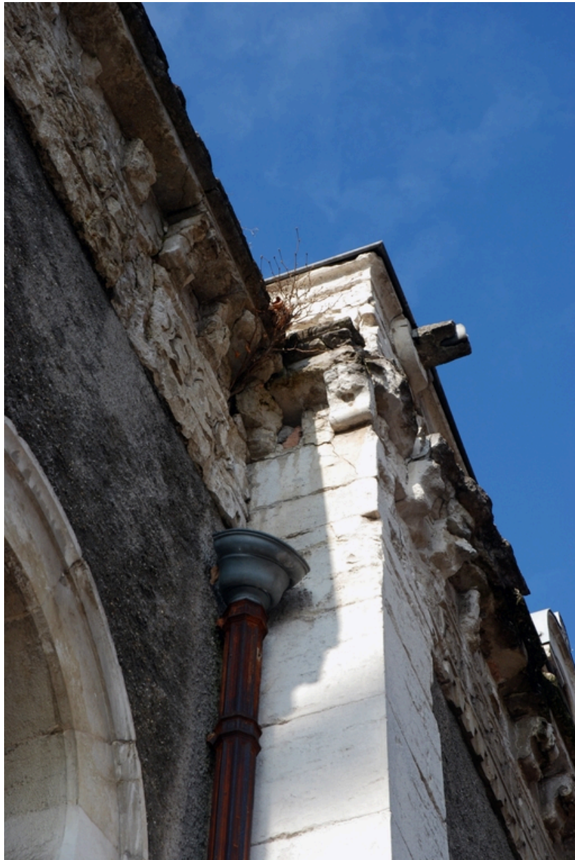
Elévation latérale ouest, détail montrant l'état de dégradation de la corniche
