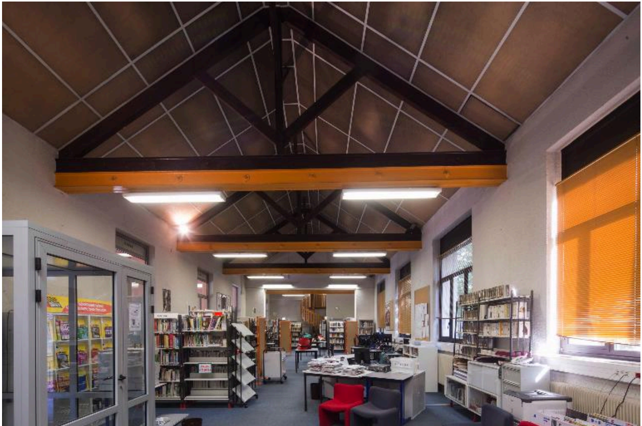
CDI situé dans le bâtiment A
