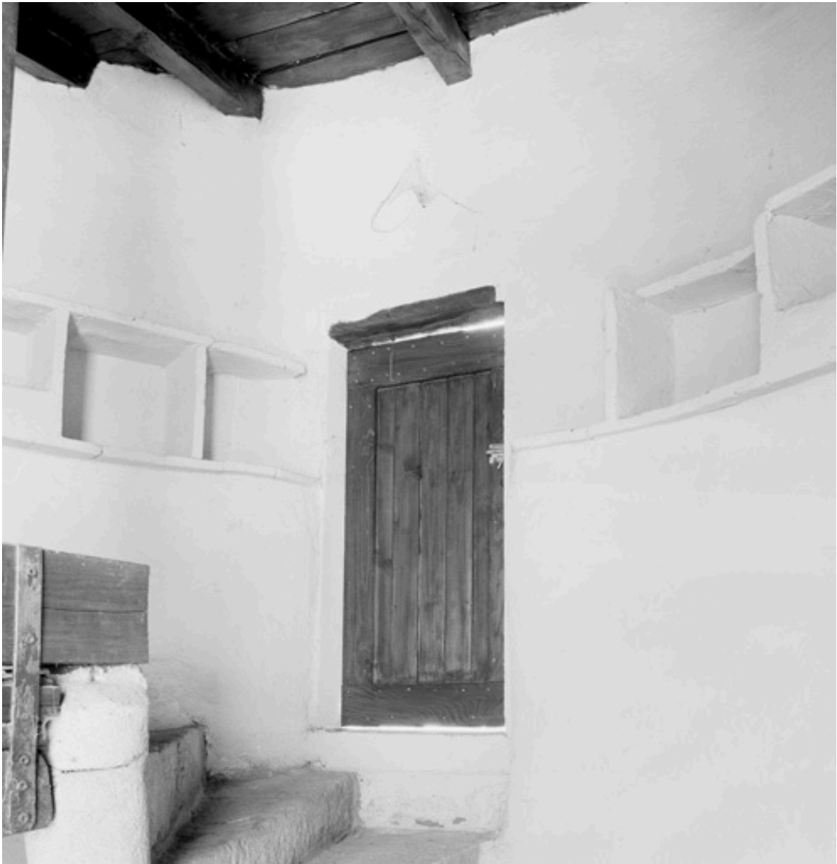
Nichoires du pigeonnier au sommet de la cage de l'escalier en vis.
