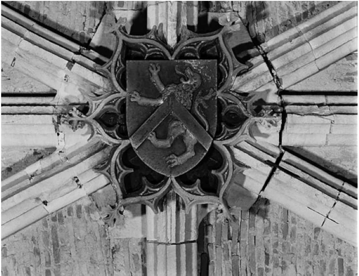
Voûte du vaisseau central en cours de restauration en 1977, travée V, détail de la clef de voûte principale aux armes de J. de Bourges
