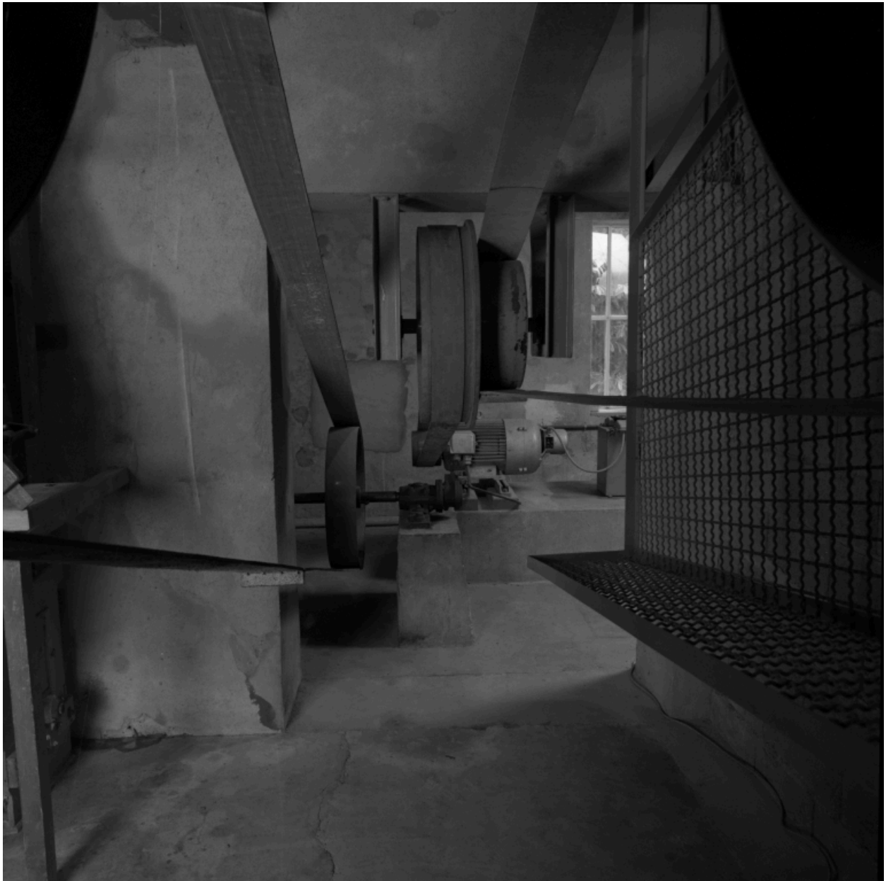
Etage de soubassement (sud) : moteur de la turbine et courroies de transmission.
