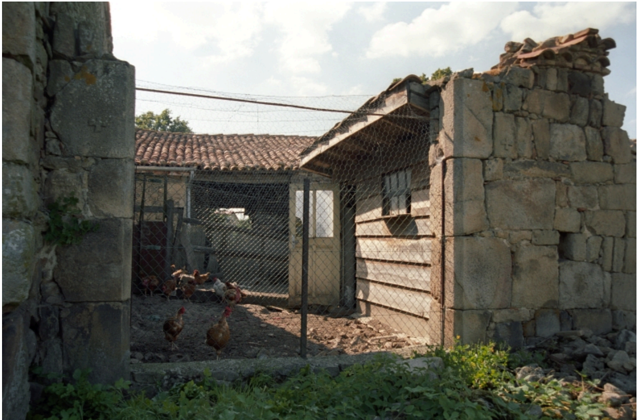
Ferme à Bruyère (B3 854), Vue d'ensemble d'un portail à encadrement de pierres.
