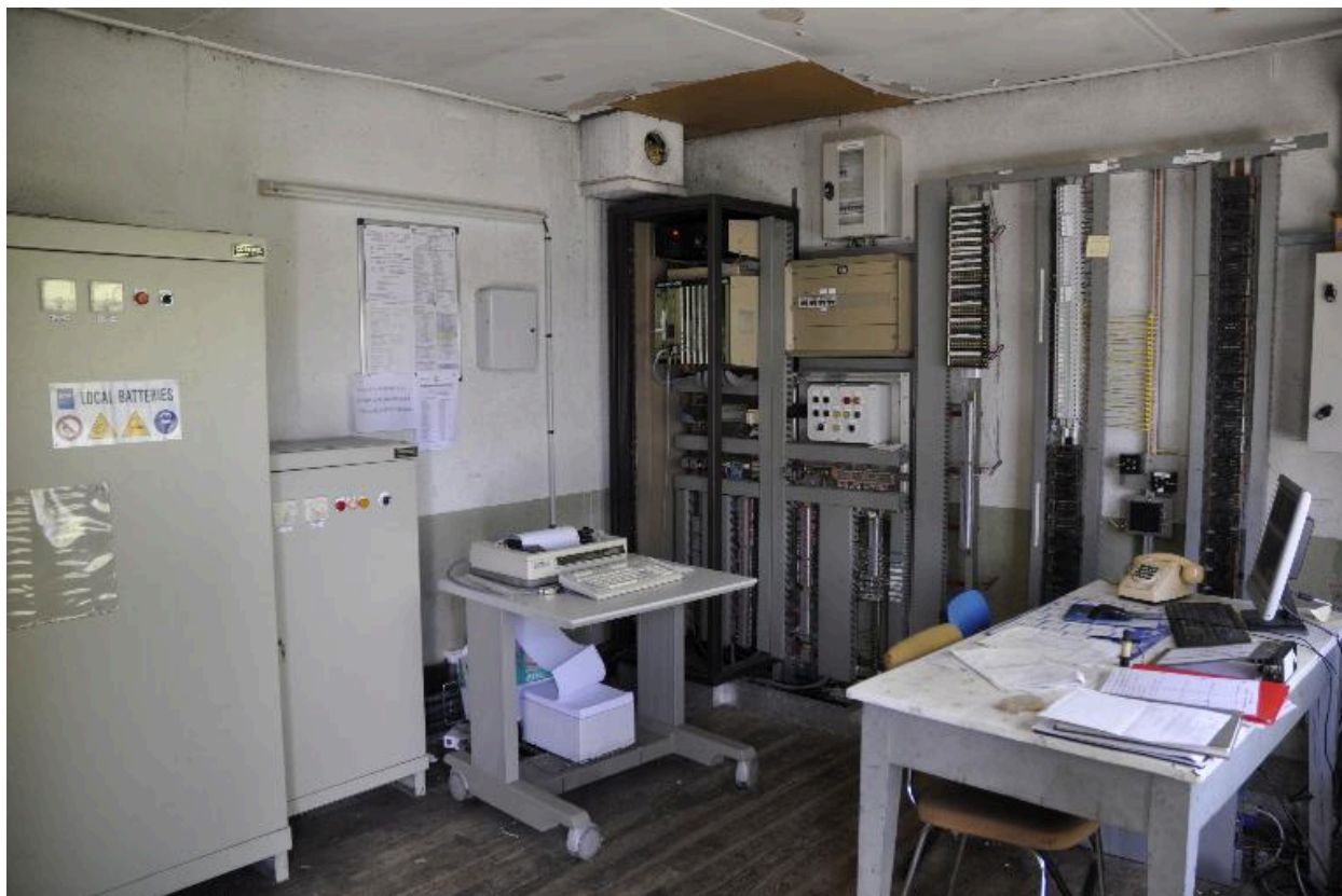
Vue de la salle des commandes du barrage
