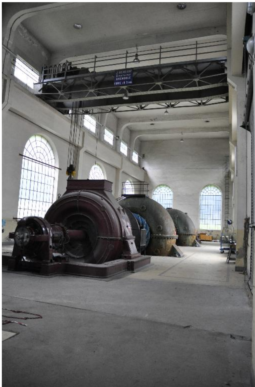
Vue de la salle des machines
