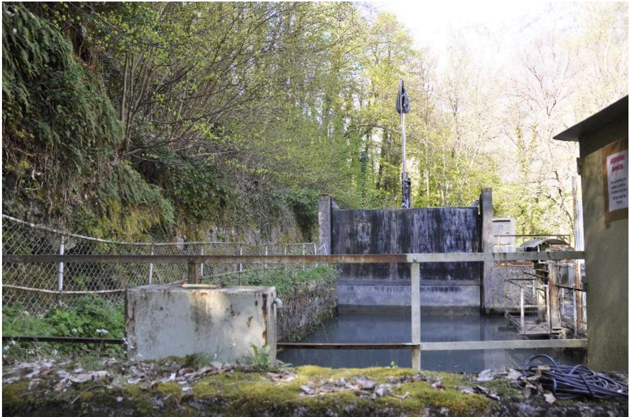
Vue de la chambre de mise en charge de Livet
