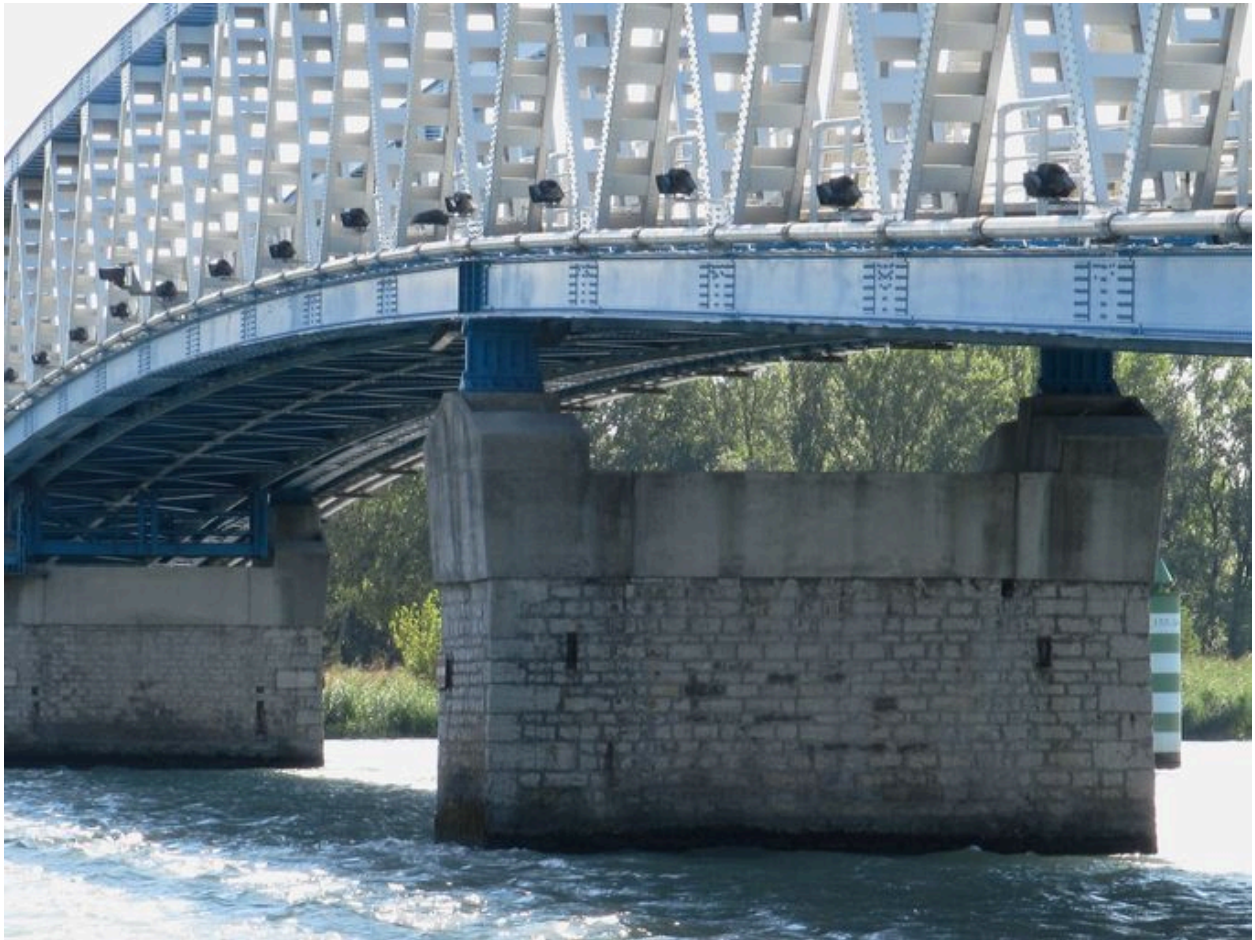
Tablier, de côté, face amont, vue partielle : jonction avec la pile (depuis la rive droite)
