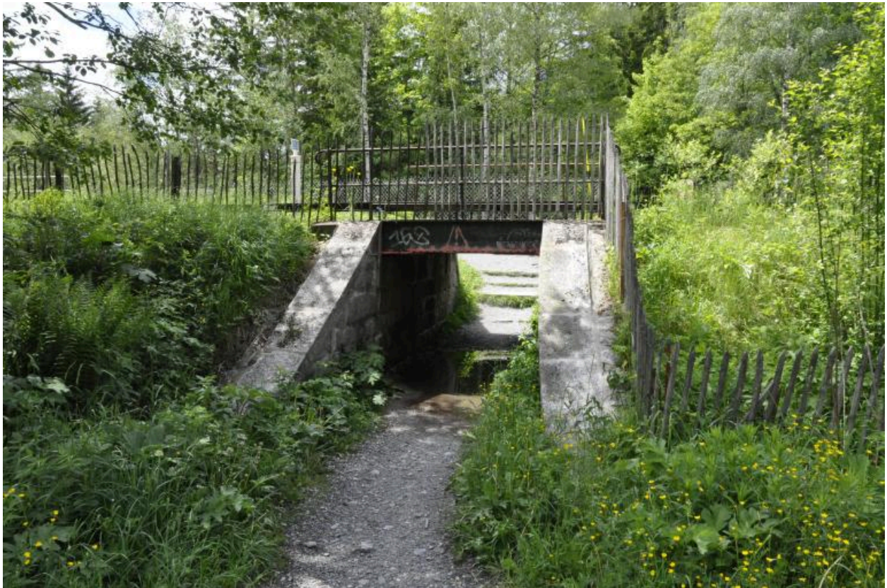
Vue de la face sud-est du pont surplombant le chemin donnant accès au chemin des Lots
