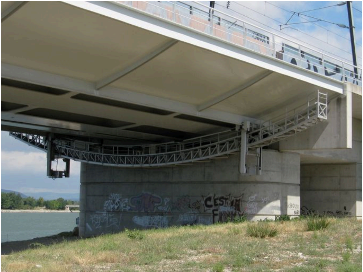
Culée gauche, de dessous, face aval, vue générale (depuis la rive gauche)
