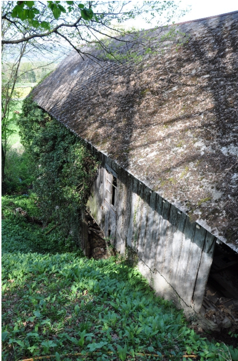
Vue sud du bâtiment, l'eau passait le long de cette façade
