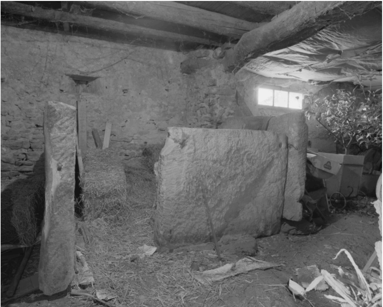
Basses Condamines, chemin de Taulignan aux carrières. Détail d'une étable : loge à brebis.
