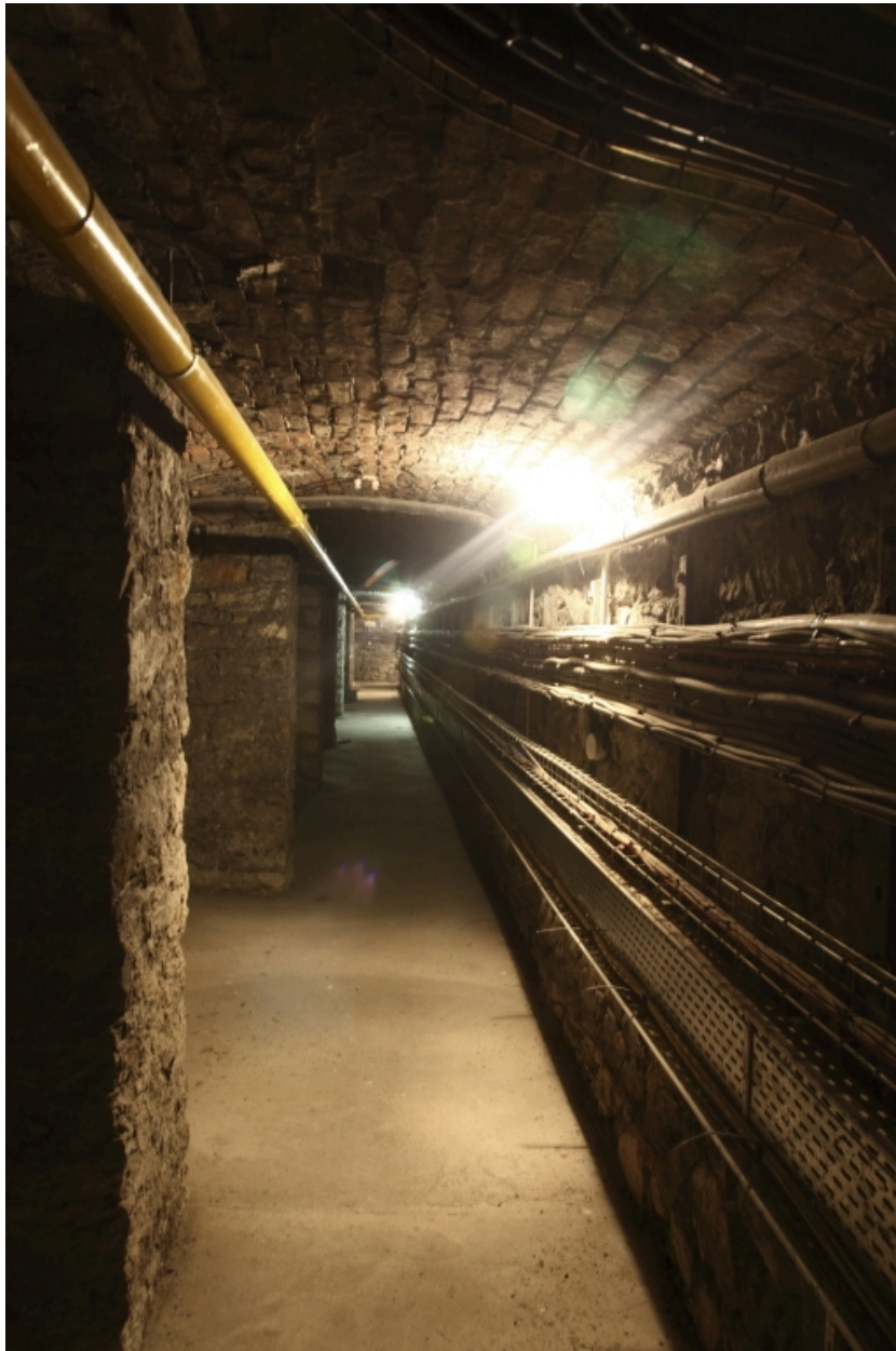
Sous-sol. Aperçu du dédale des galeries, circulation des fluides.
