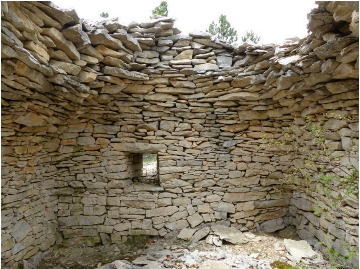
Mur nord, arrachement de l'encorbellement.
