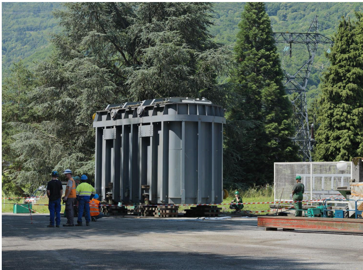
Transformateur 15 kV / 400 kV stocké à l'extérieur de la centrale
