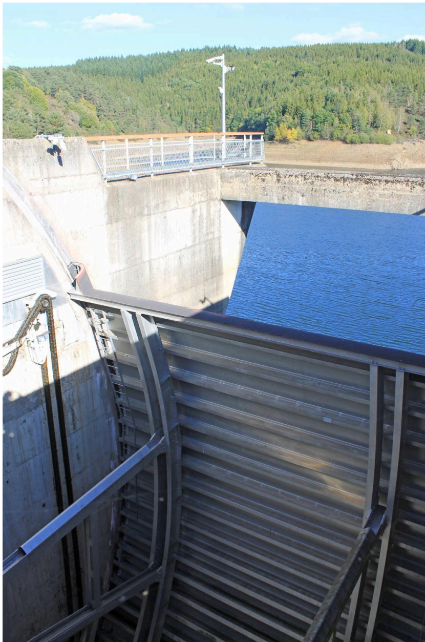
Neuvéglise-sur-Truyère - Fridefont, barrage de Grandval, la vanne de l'évacuateur de crues sud.
