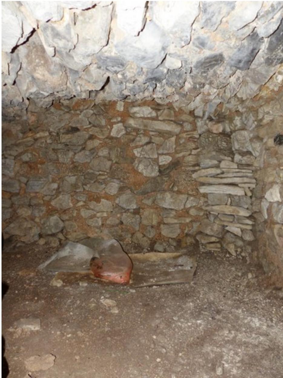
Etage de soubassement, étable à cochon. Vue de volume prise du sud.
