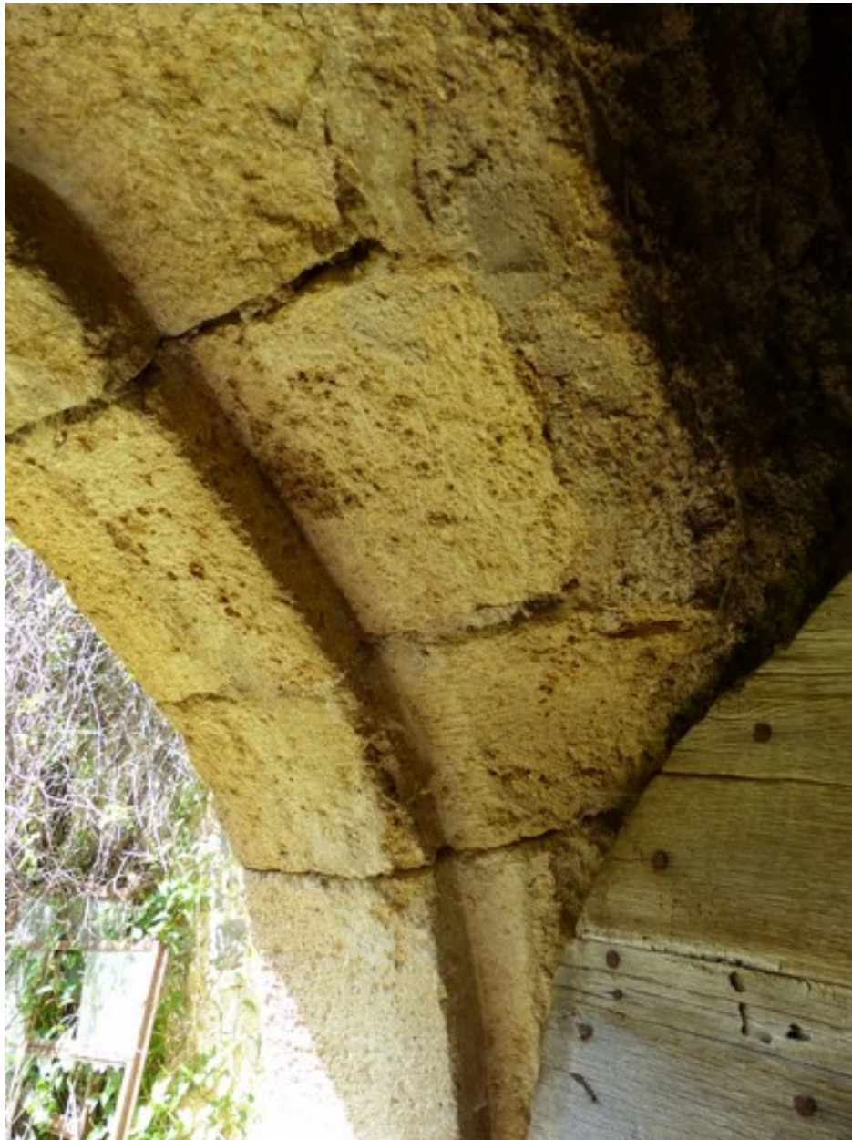
Ensemble oriental. Partie centrale. Etage de soubassement, écurie. Mur ouest, porte. Détail de l'encadrement.
