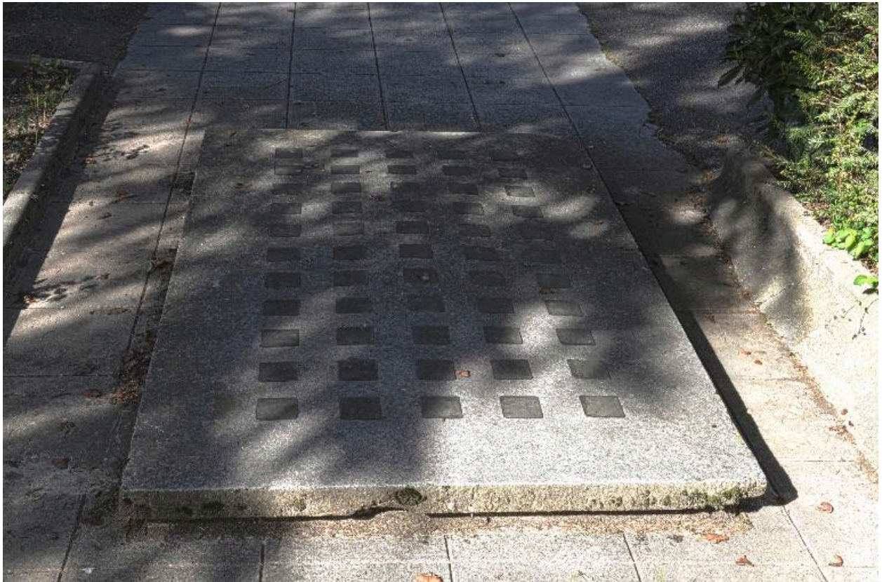
Pavés de verre éclairant les galeries souterraines
