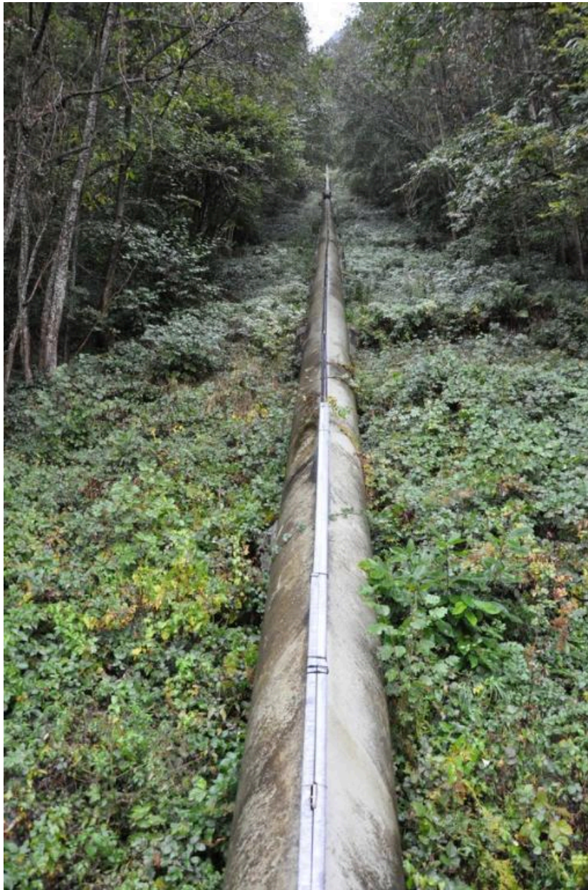
Conduite forcée vue depuis la route menant au hameau de la Planche (vue amont)
