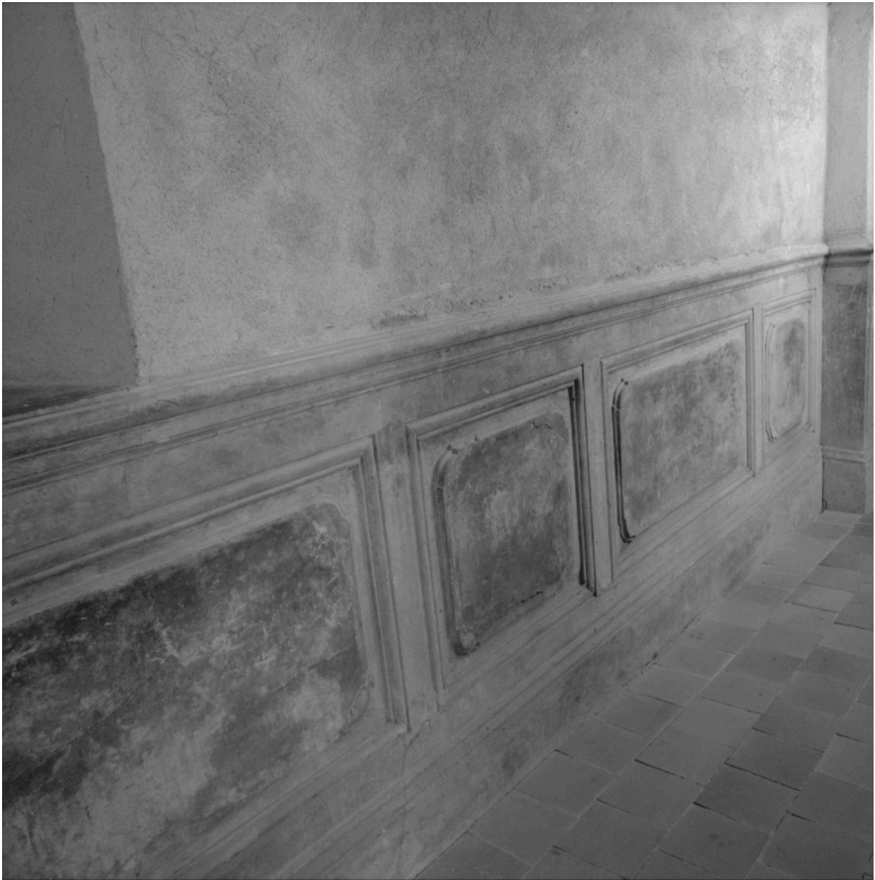
Bastion sud-ouest, premier étage, couloir menant de la chambre dite de Claude d'Urfé à la chambre du bastion ouest : détail de l'enduit de revêtement des murs.
