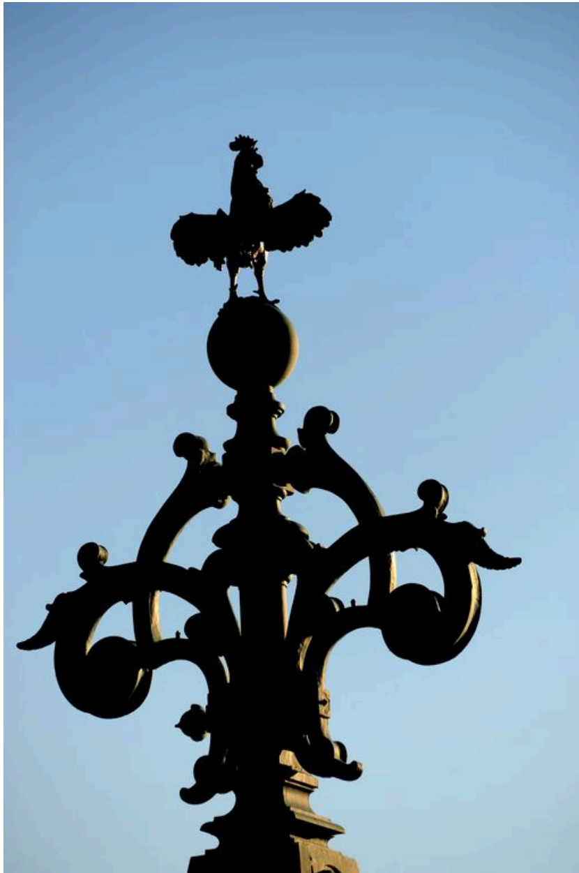
Pile, vue de détail : sommet du décor au-dessus du tablier, coq aux ailes déployées (depuis la chaussée)
