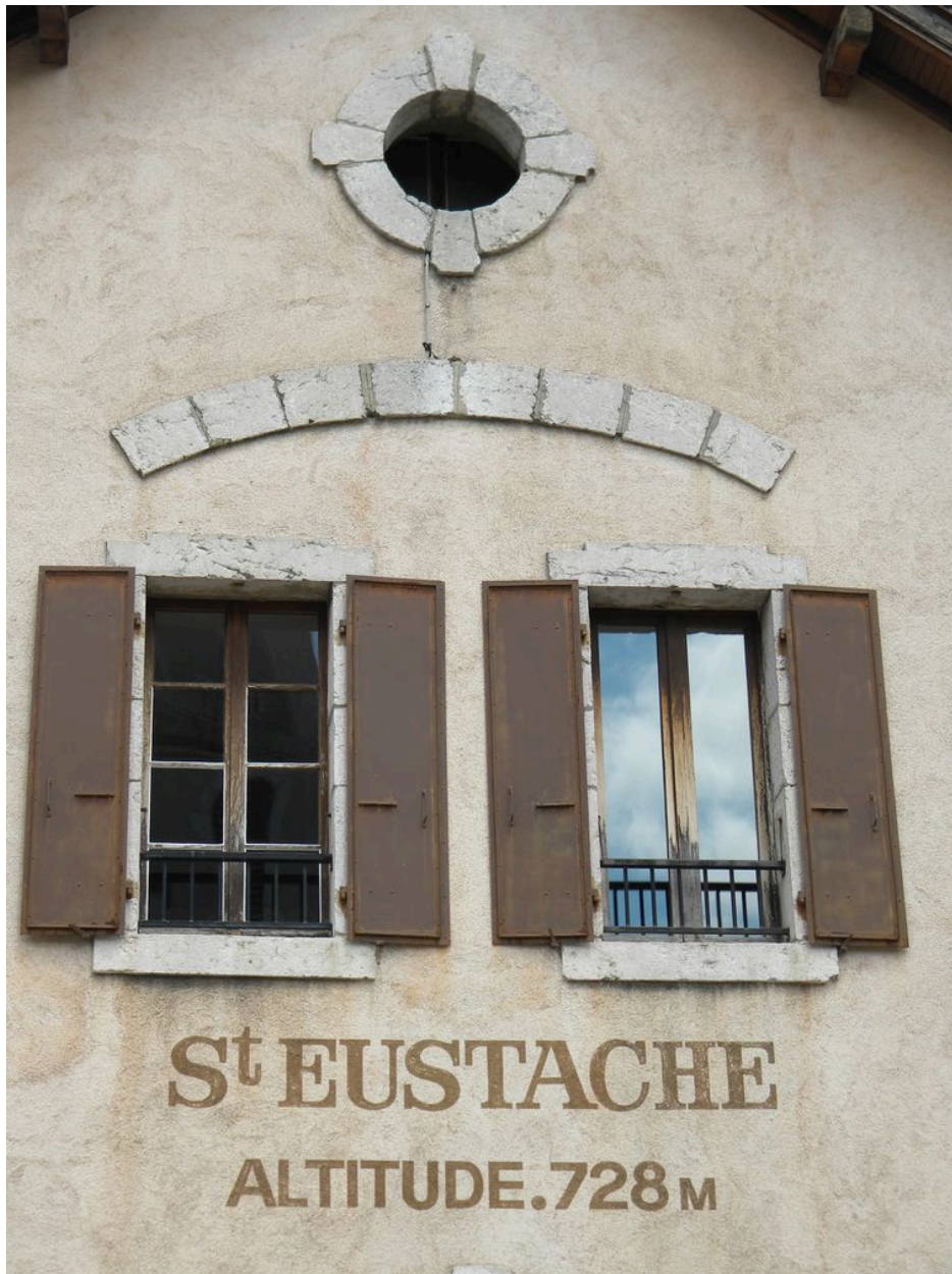
Détail de la façade principale avec l'inscription et l'arc de décharge apparent.
