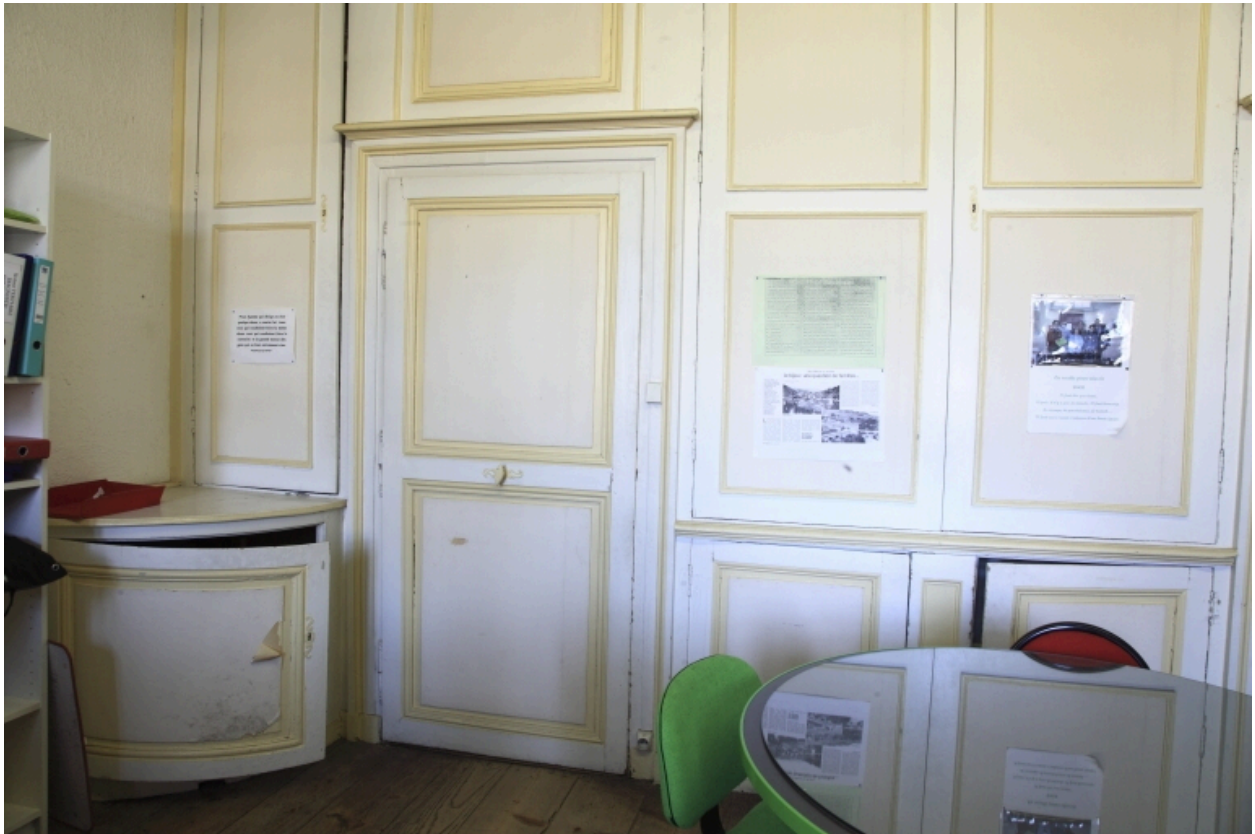
Bâtiment A, 1er étage. Greta. Bureaux sur l'aile orientale. Lambris et portes.
