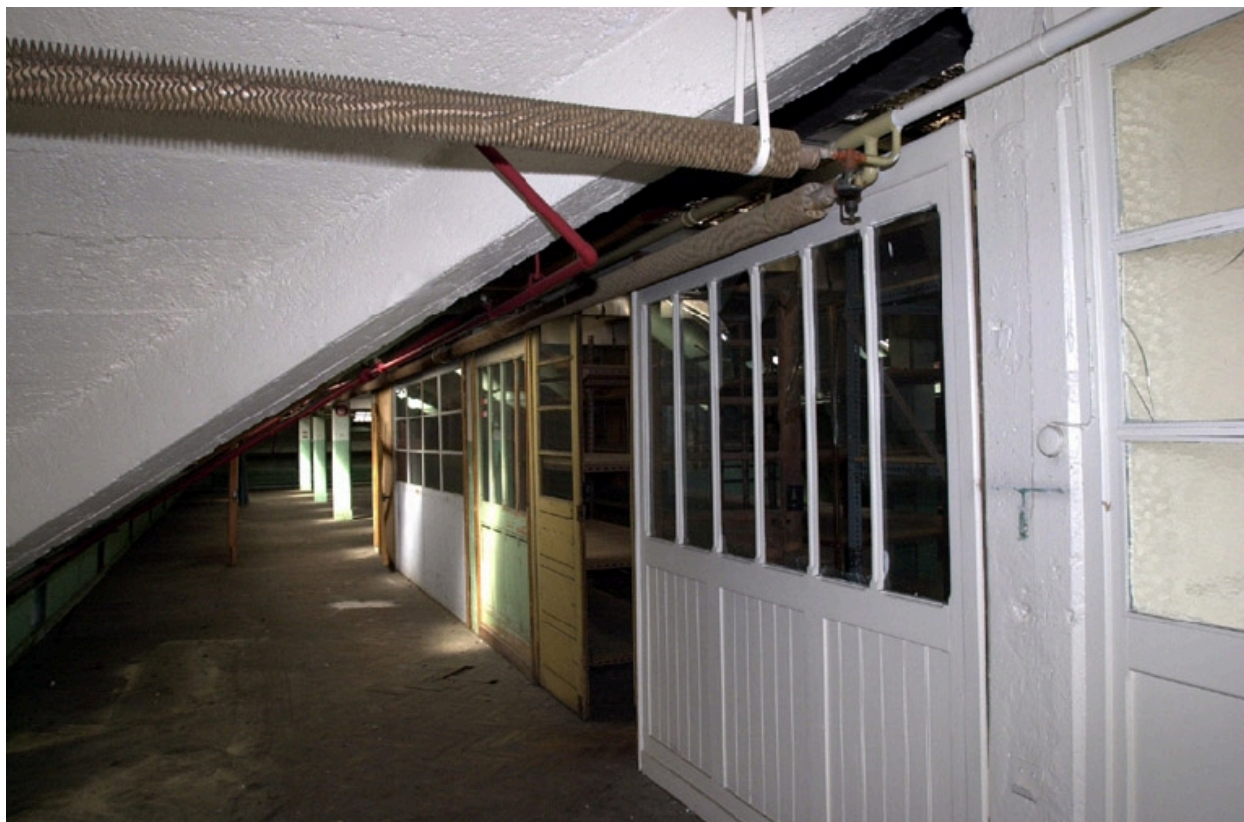
Système de chauffage dans la sous-pente
