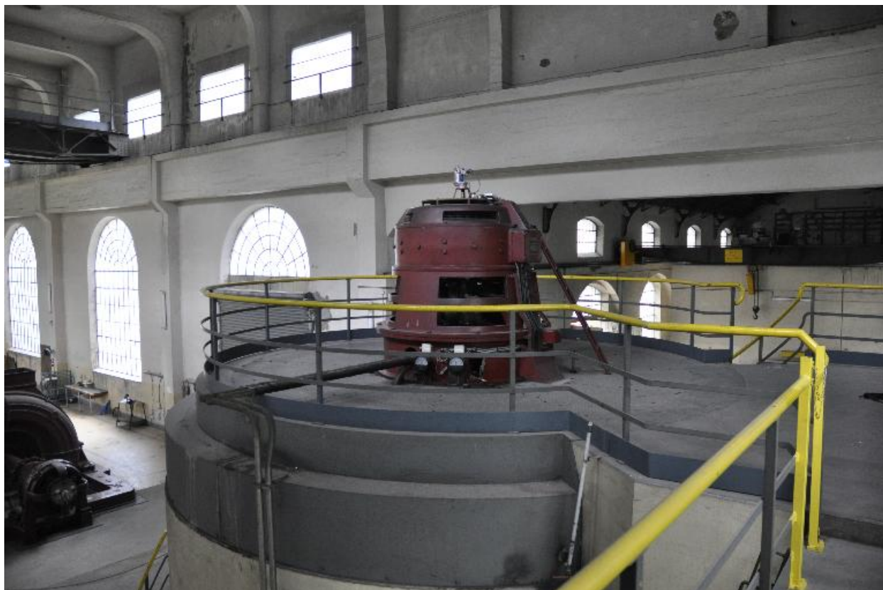
Vue d'un groupe vertical du bâtiment des Clavaux à la charpente en béton
