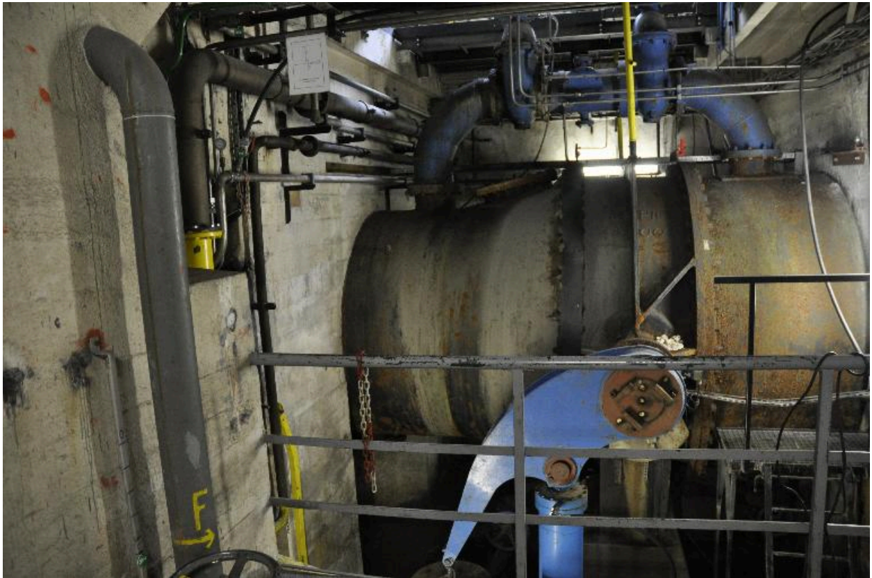
Vue des installations des groupes au sous-sol
