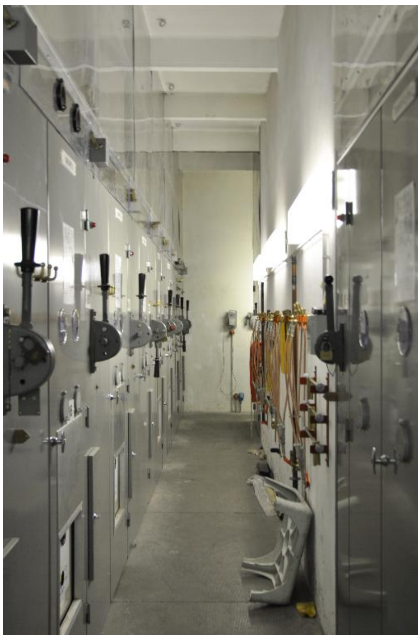
Vue de la salle des transformateurs
