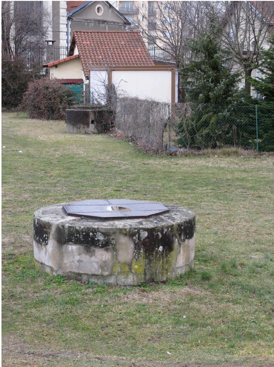
Regards des bassins filtrants sur le terrain
