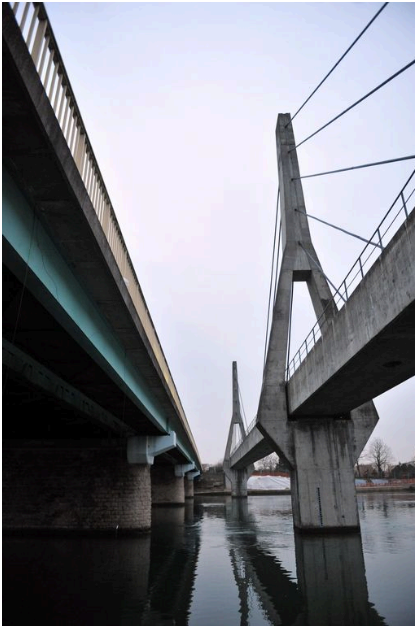
Vue partielle, de côté, tablier et piles, face aval (depuis la rive droite)
