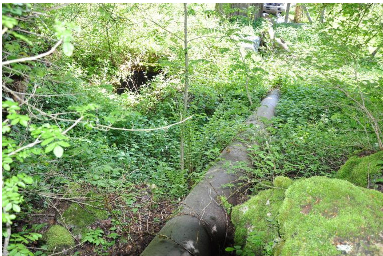
Vue de la conduite forcée.
