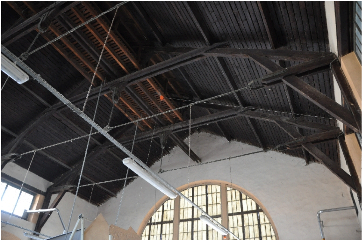
Vaisseau central : charpente en bois, vue sur le passage supérieur du lanterneau
