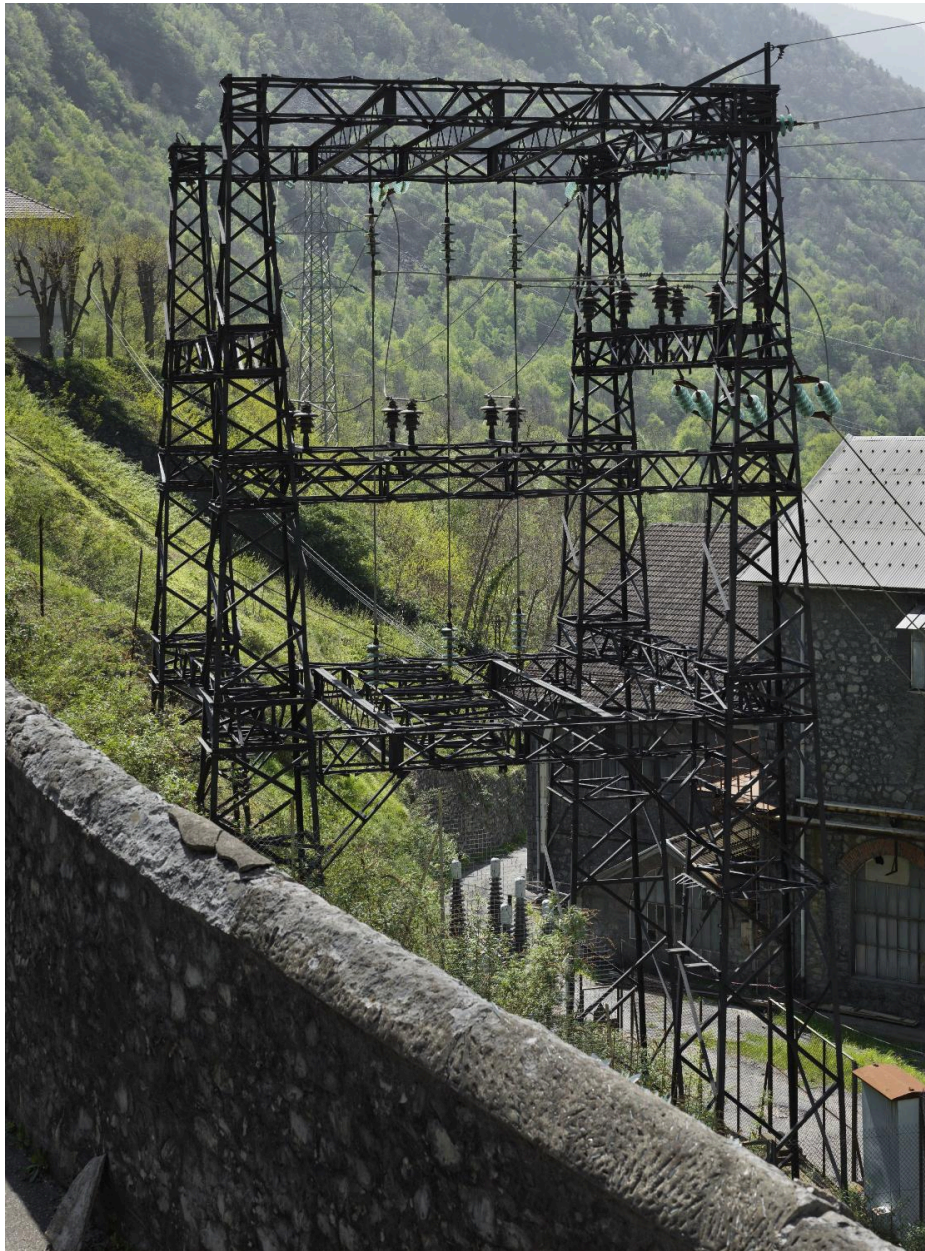
Pylône électrique portant les conducteurs d'une ligne à haute tension
