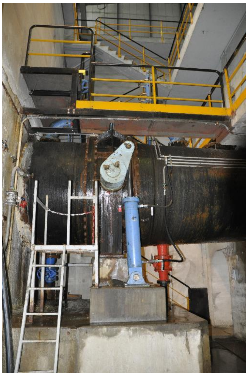
Détail d'une partie d'une turbine d'un groupe vertical
