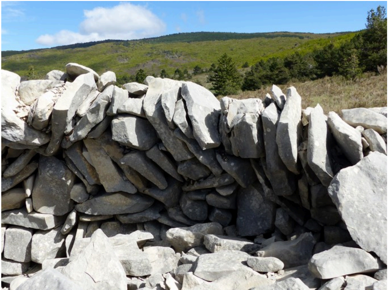
Arrachement d'un départ de coupole clavée, cabane au quartier de Banastier.
