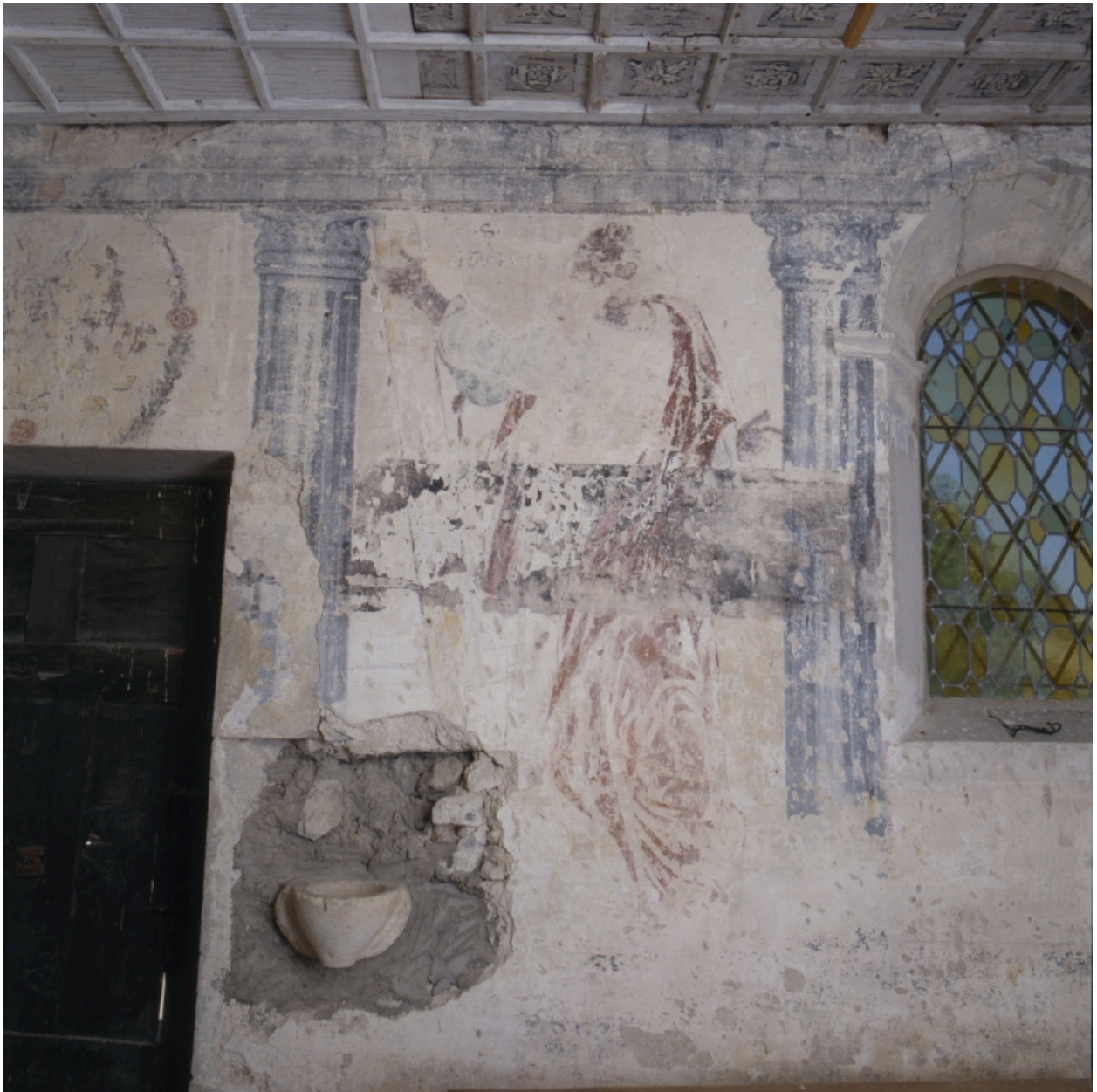
Mur nord-est, trumeau entre la porte et la fenêtre : saint Jude Thaddée entre deux colonnes en trompe l'oeil.
