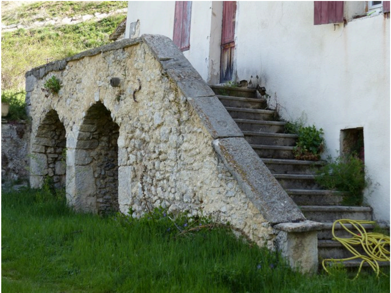
Bâtiment du logis. Elévation ouest, premier niveau. Escalier extérieur et palier filant sur deux voûtes en berceau.
