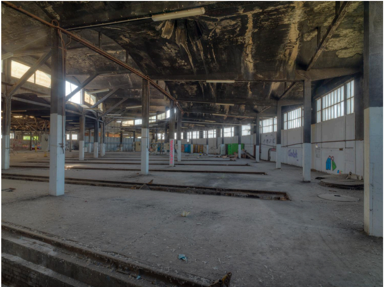
Vue d'ensemble latéral des fosses de réparation
