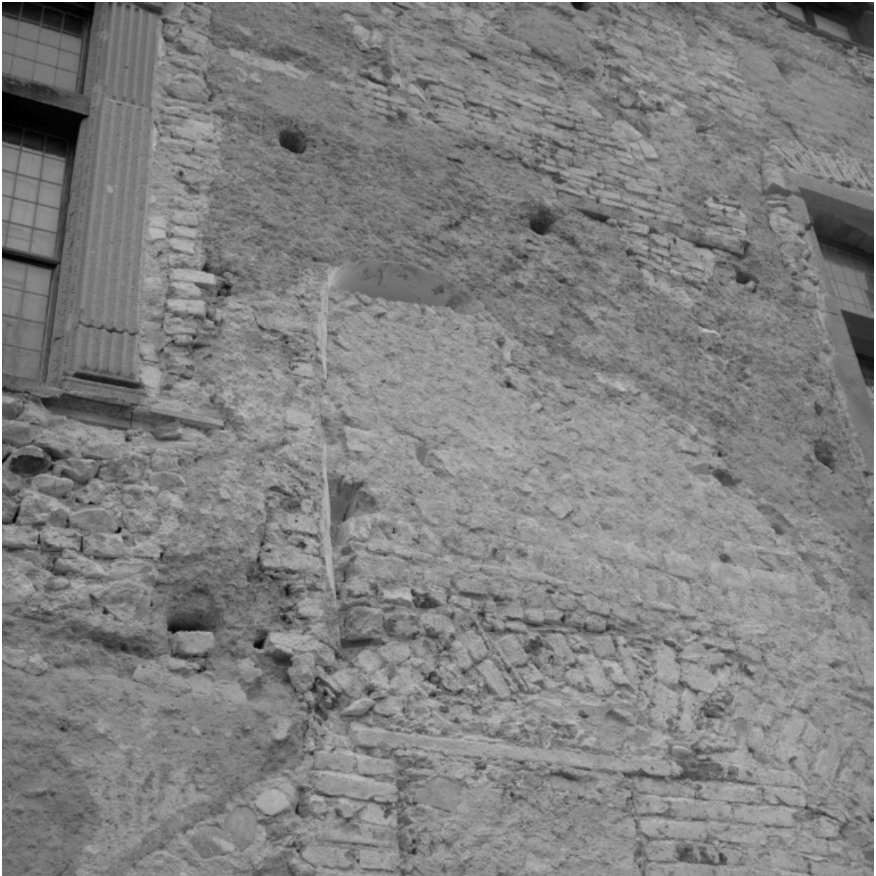
Façade sur jardin du corps de galerie après décroûtage, partie sud du corps primitif en pisé : détail d'une baie bouchée.
