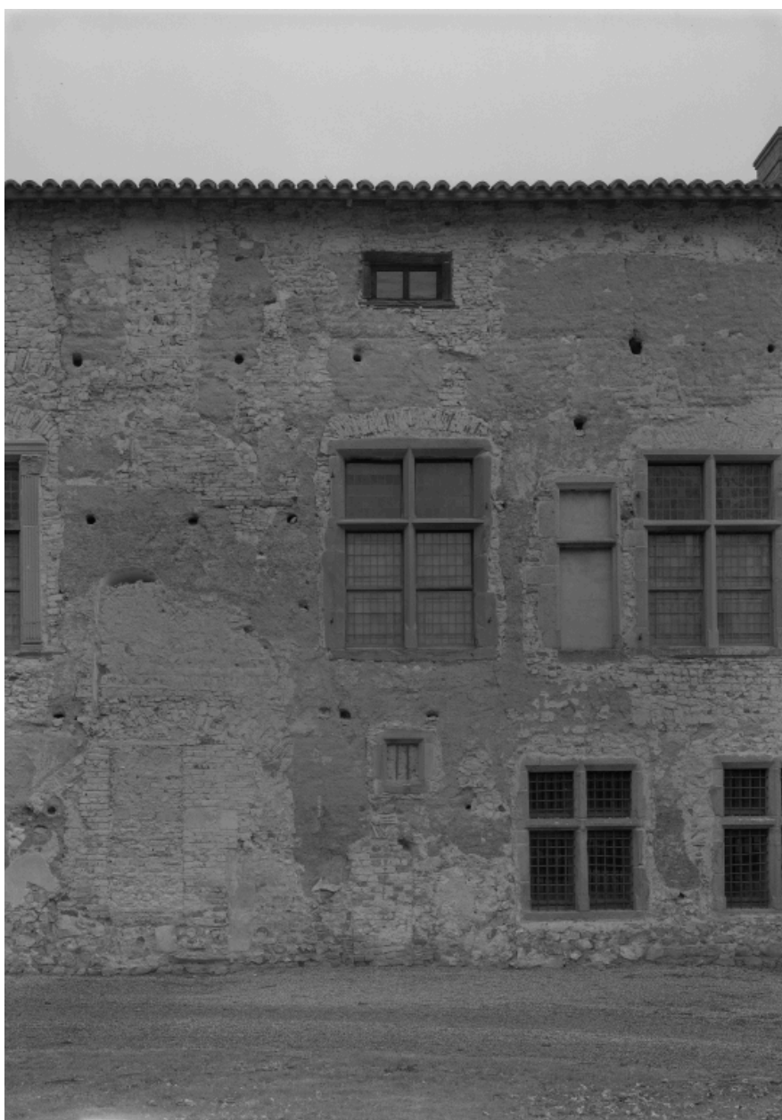
Façade sur jardin du corps de galerie après décroûtage : détail de la partie sud du corps primitif en pisé.
