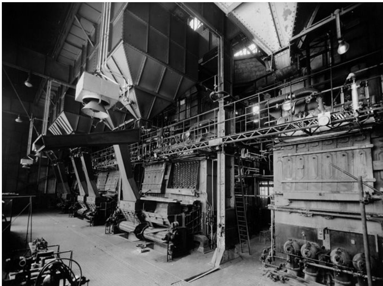
Centrale thermique. Photogr., avril 1958. Groupe de chaudières Niclausse
