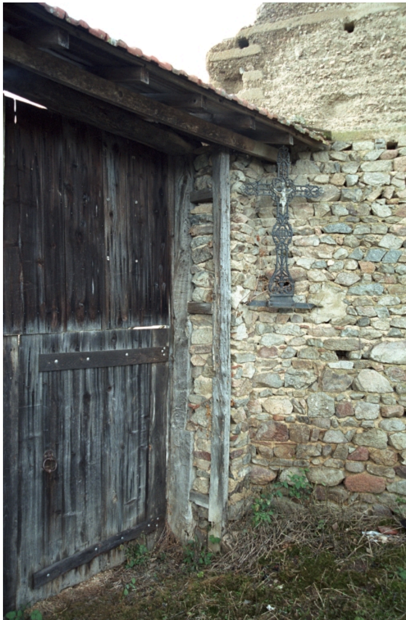
Ailleux, Bourg, croix de chemin en fonte de type E (1987 A1 18). Vue d'ensemble de face.
