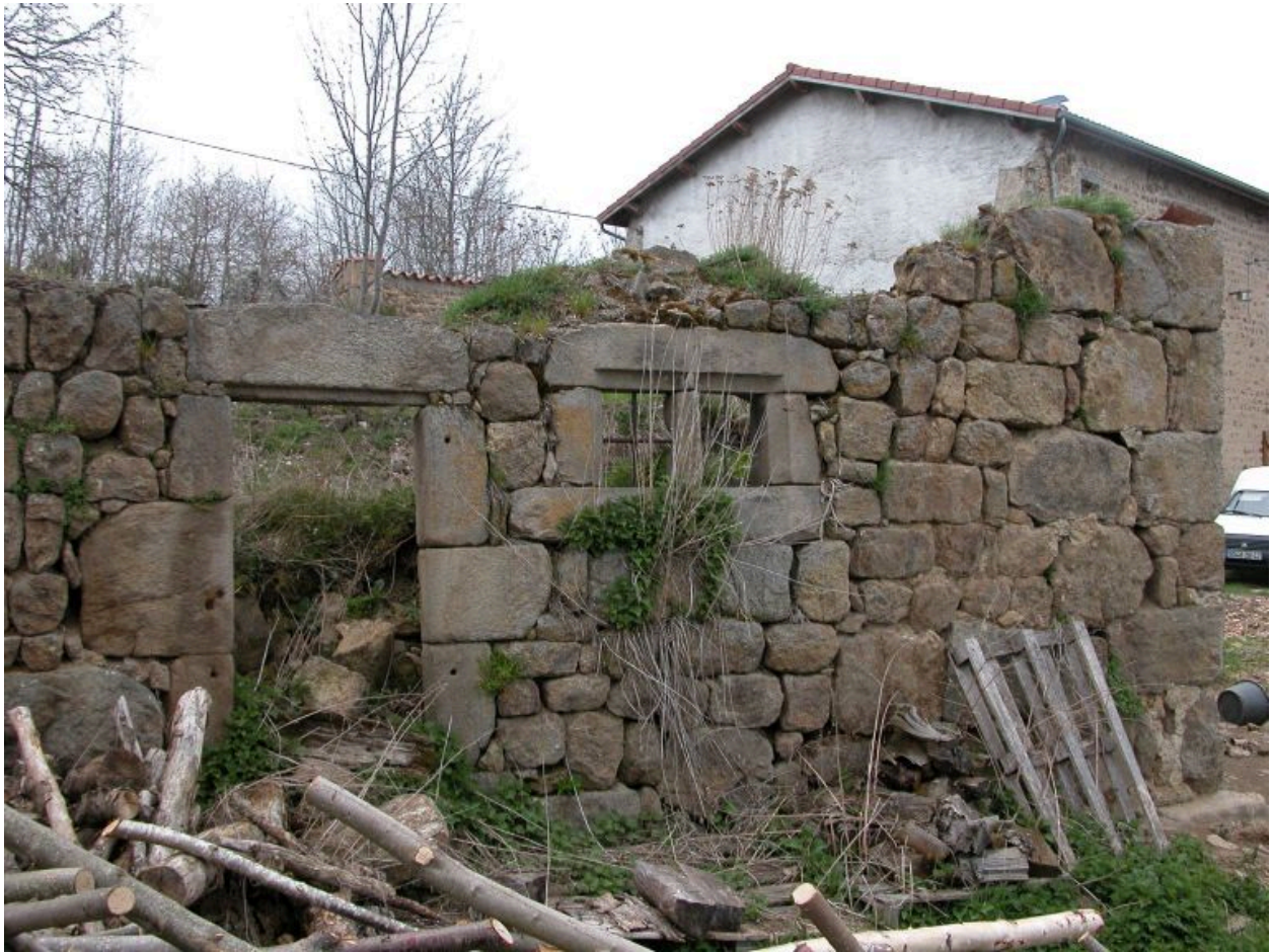
Bâtiment en ruine avec remplois d'éléments d'encadrement anciens.
