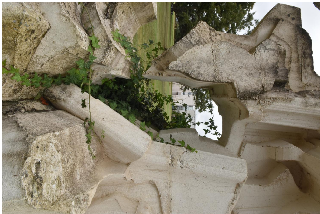
Détail des altérations : envahissement par la végétation
