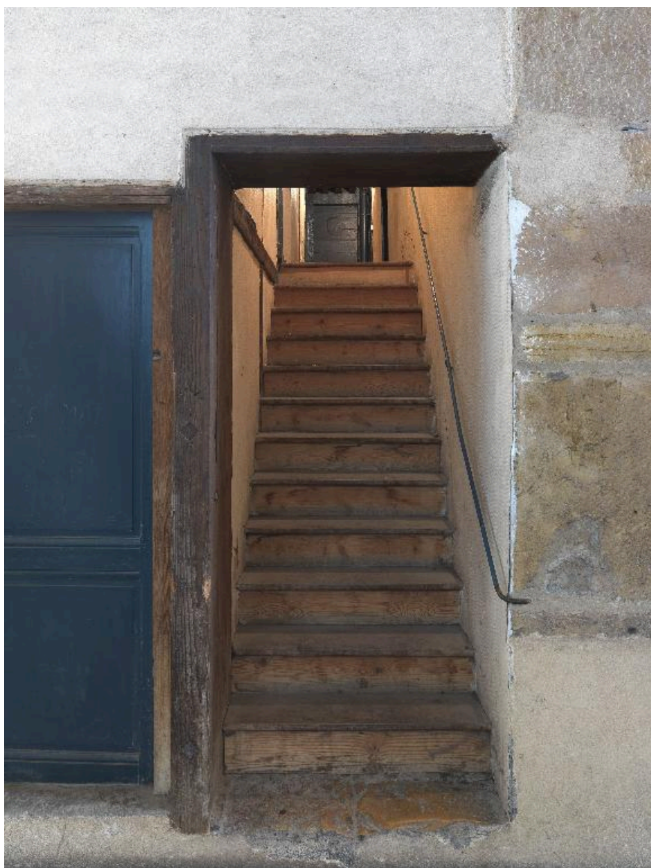
Vue de l'escalier secondaire en bois desservant un seul niveau du n°4 rue Dumenge
