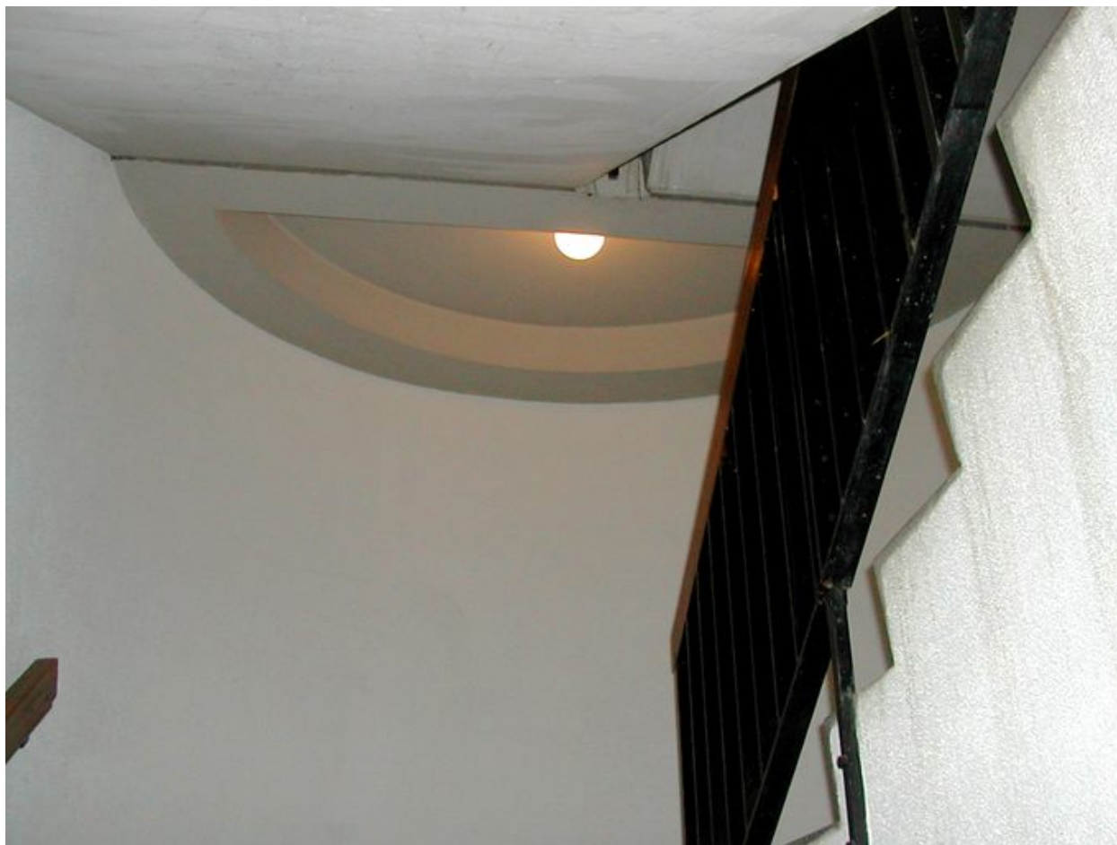
L'éclairage de la cage d'escalier
