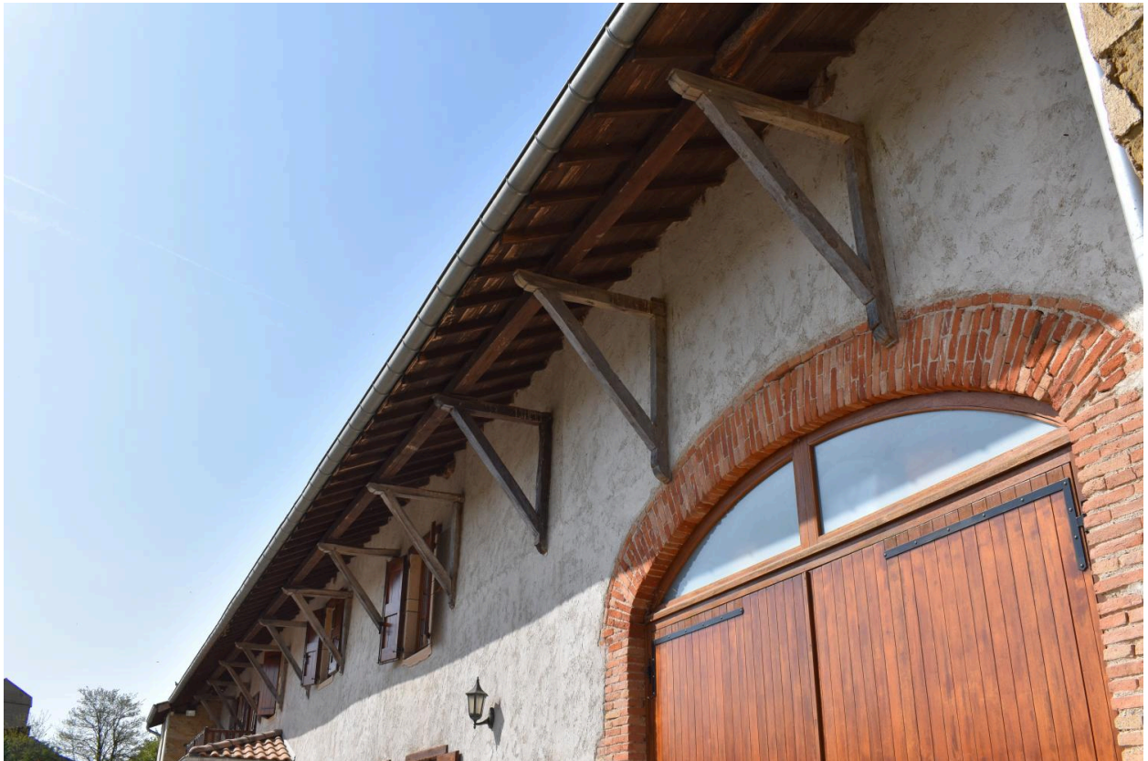
Alignement de consoles
