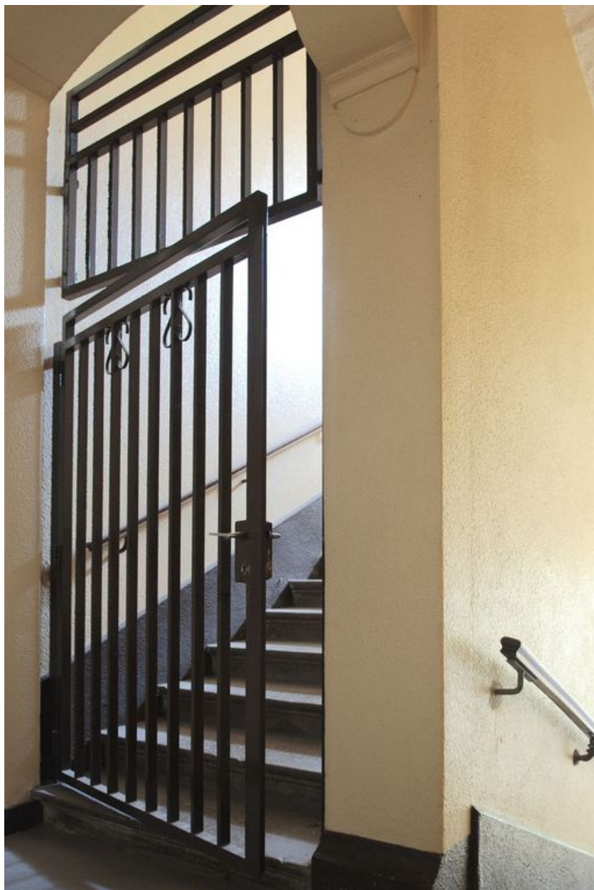
Escalier du bâtiment 504 : grille du palier du premier étage
